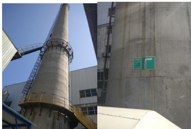
图 3-5 废气排放口采样平台和标识牌
