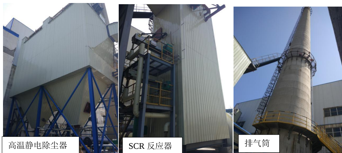
图 3-1 废气处理设施和排气筒
